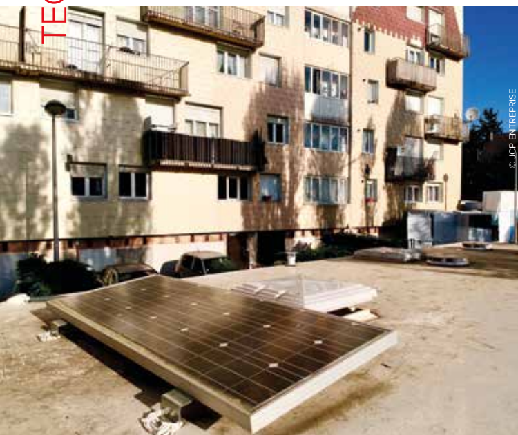
▲ UNE ENTREPRISE MEMBRE DE L'ASSOCIATION RQE A MIS À DISPOSITION DES BASES VIE AUTONOMES CONFORTABLES ET PARFAITEMENT ISOLÉES AVEC PANNEAUX SOLAIRES, ÉCLAIRAGES LED ET MINUTEURS, POMPE À EAU ÉLECTRIQUE, PRODUITS DE NETTOYAGE BIODÉGRADABLES...
